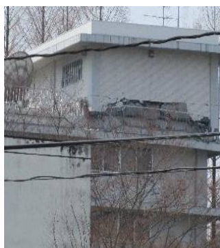
校舎の上階が被災した例
