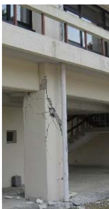
2階建校舎の1階の柱が被災した例
